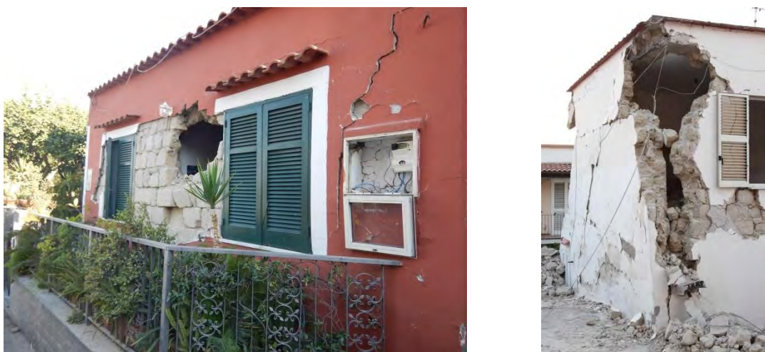
Figura 3.6-2. Casamicciola "Zona Rossa": espulsione di muratura e rottura dell'angolata muraria in edifici di classe B.
