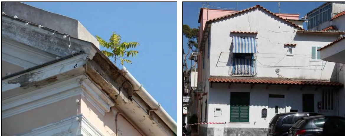
Figura 3.6-4. Marina di Casamicciola: distacco del cornicione dalla Chiesa di S. Maria della Pietà e lesioni leggere in un edificio in muratura.
