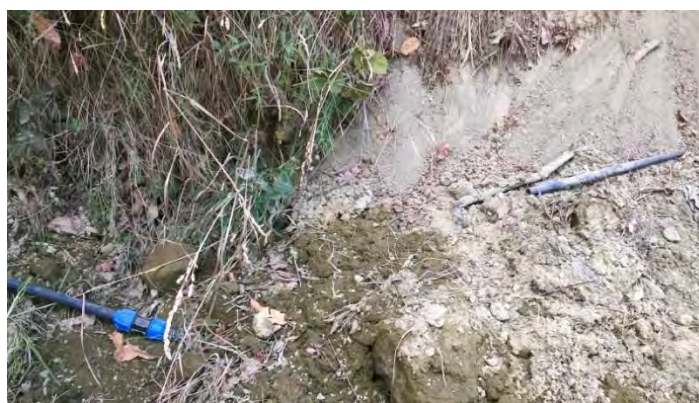
Foto 5. Particolare del danno al tubo di irrigazione.
