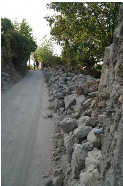
Foto 8. Crollo di un muretto a secco.
