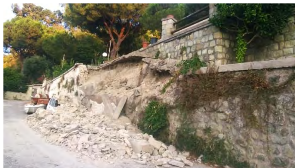
Foto 14. Danni al muro di contenimento e al manufatto.
