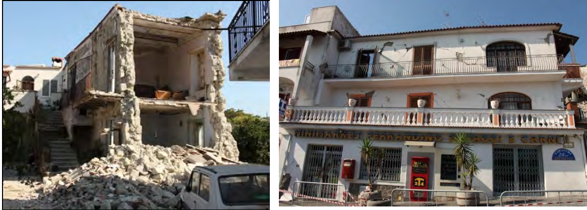
Figura 3.6-3. Fango (Lacco Ameno): crollo parziale e lesioni passanti alle murature.
